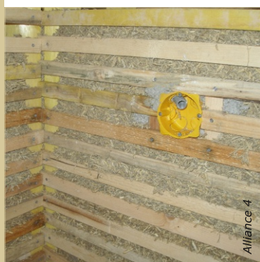
Les boîtes électriques sont scellés au mortier chaux/plâtre ou plâtre pour éviter le risque d'incendie en cas de court-circuit.
