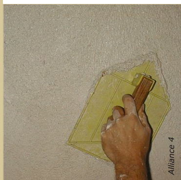
Le talochage est un mouvement circulaire bien appuyé. Il permet d'obtenir la planéité en égalisant les creux et les bosses. Rajouter localement de la matière si besoin.
