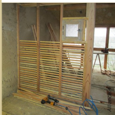
Fixer régulièrement le lattis : présenter plusieurs lattes contre les montants, clouez-en une sur deux. Retirer les lattes non fixées.
