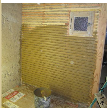
Appliquer la barbotine de toutes parts. Elle sert à minéraliser le support pour favoriser l'adhérence du corps d'enduit.
